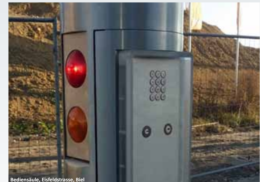
Bediensäule, Eisfeldstrasse, Biel
